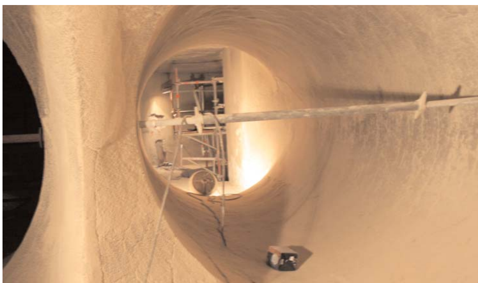
Das Steigrohr zu den Abscheidezyklonen hat einen Durchmesser von 2.900 Millimetern und ist komplett mit WearStop ausgerüstet. (Foto: wed)
