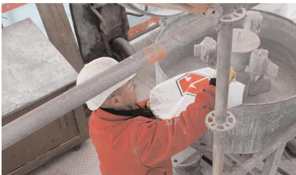
Die Verschleißschutzmasse WearStop wird in einem Mischer angerührt und manuell mit Kelle und Glätter aufgetragen. (Foto: wed)
